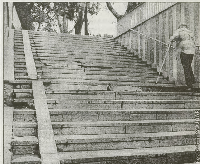
Kraków, ul. Zakopiańska. Przejście podziemne obok pętli tramwajowej. Mamy nadzieję, że po remoncie schody będą solidniejsze i wreszcie pomyśli się o niepełnosprawnych
