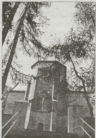
Wybudowany na początku tego stulecia kościół w Zalasie wymaga remontu
