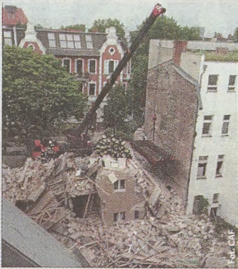
Eksplodacja całkowicie zniszczyła czteropiętrową, około stuletnią kamienicę.
