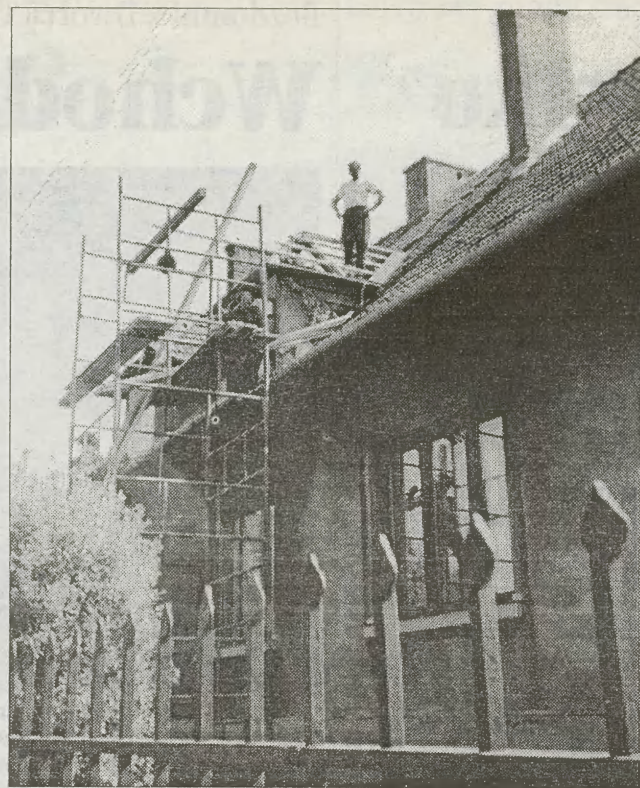
Na tej budowie prace na wysokości prowadzone są bez zabezpieczenia, a rusztowanie jest nieprawidłowe
