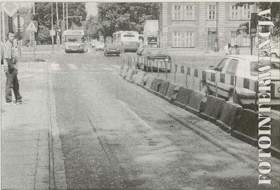
Dobiega końca remont mostu Dębickiego. Dotychczasowy ruch — w tym także autobusowy — odbywa się na zastępczych trasach. Ciężar — prawdopodobnie autobusów — powoduje na pasie, na którym się poruszają, głębokie koleiny. Nasuwa się jeden wniosek, po otwarciu mostu, do remontu natychmiast powinny pójść Aleje Tekst i zdjęcie: Adam WOJNAR
