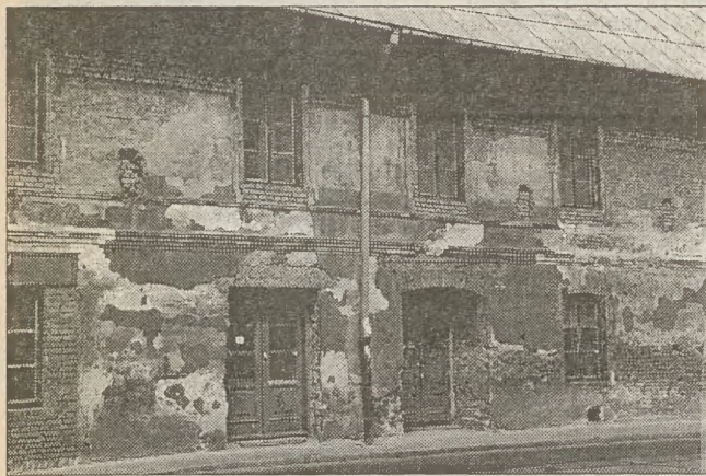
Kraków, skrzyżowanie ul. Piłsudskiego z Garncarską — dom w którym była pracownia Jacka Pugeta, dzisiaj już ruina...
