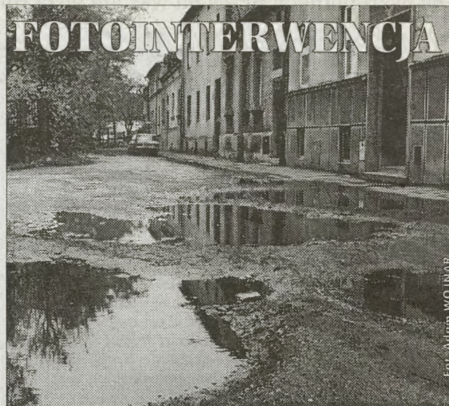
Kraków. Ul. Zduńska znajduje się w pobliżu ronda Grunwaldzkiego. Jak widać, zapomnieli o niej drogowcy, zapomnieli i gospodarze Dębnik. Ulica ta nie ma nawet asfaltowej nawierzchni. Właściwie czy takie wyboje i dziury można nazwać ulicą?
