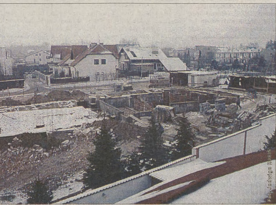
Na Os. Kliny przy ul. Zagaje wśród jednorodzinnych domów rośnie ogromny nowy kościół. Dotąd mieszkańcy tej części miasta, musieli peregrynować do kościoła na Górze Borkowskiej. (J.R.)
