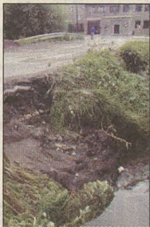
Rybnianka podmyła spory odcinek drogi w centrum wsi
