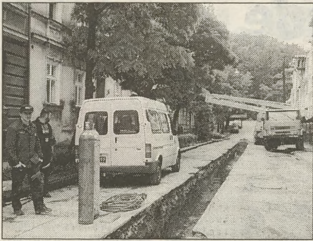
Powoli kończą się prace przy wymianie rur centralnego ogrzewania wzdłuż ul. św. Benedykta. Droga nadal jest zamknięta dla samochodów. Została rozkopana. Na ul. Rękawka można się dostać skręcając z ul. Limanowskiego w Krakusa, potem należy skręcić w lewo w ul. Rękawka
