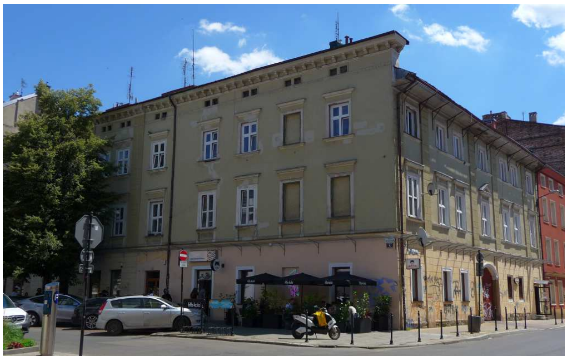
Fot. nr 399. 200-letnia kamienica w narożu ulic: Augustiańskiej 26 i Węglowej 4, której ciekawą fasadę szpecą niejednorolite okna. (05.07.2024)
