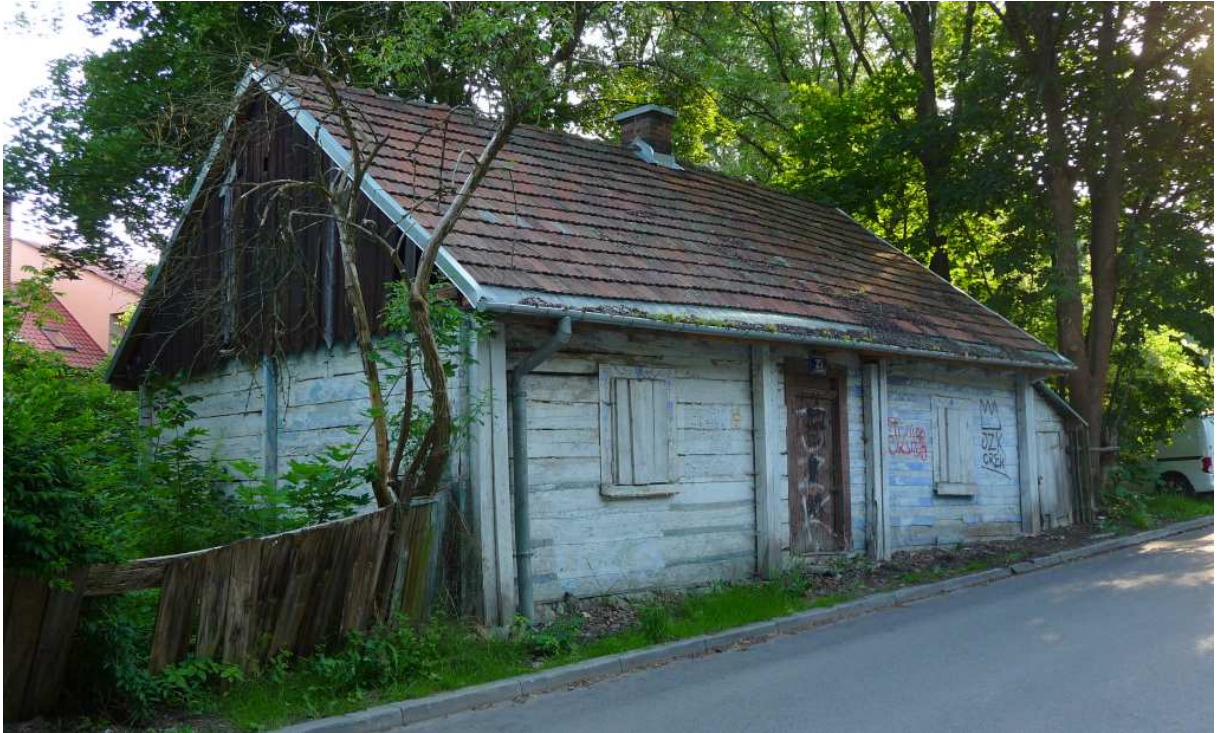
Fot. nr 328 (328-329). Drewniana chałupa z roku 1912 pod nr 25, na szczęście z nowym już dachem. (08.06.2024)
