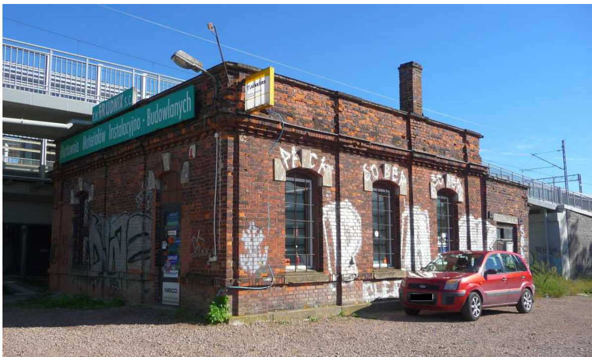
Fot. nr 367 (367-368). Stacja pomp dla parowozowni w Płaszowie przy stacji kolejowej Zabłocie. (10.10.2024)
