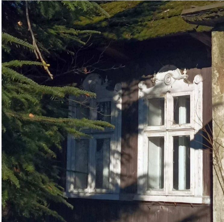
Fot. nr 124. Okna, zapewne około 100-letnie, w lewej, tylnej części domu. (04.12.2024)
