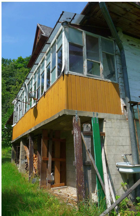
Fot. nr 79. Podwieszony, nieoryginalny ganek nad znajdującą się w przyziemiu zapewne dawną stajnią. (09.07.2024)
