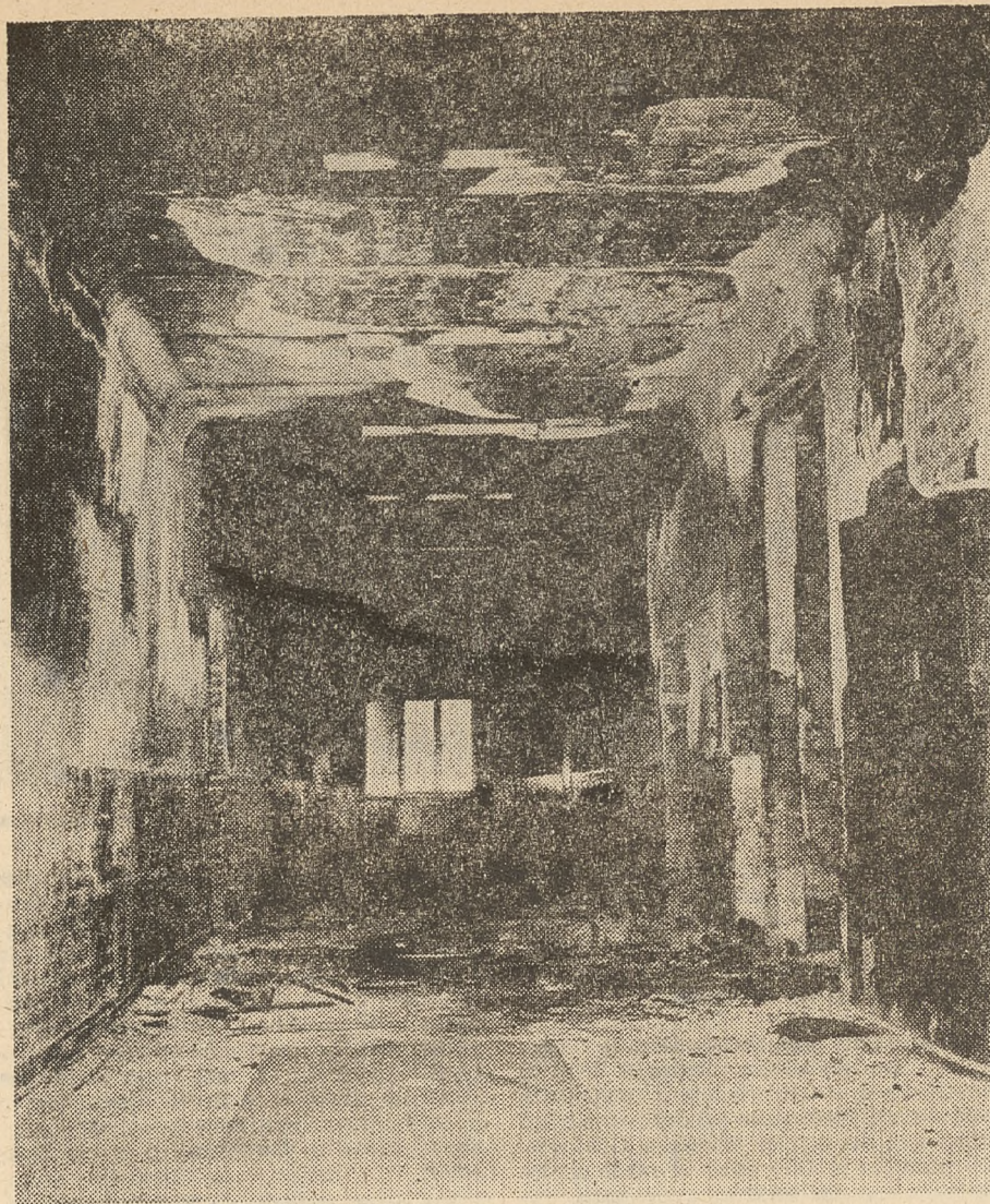
Wali pierwszego piętra w cztery dni po tragedii. Z prawej strony we wnęce episcentrum pożaru.
