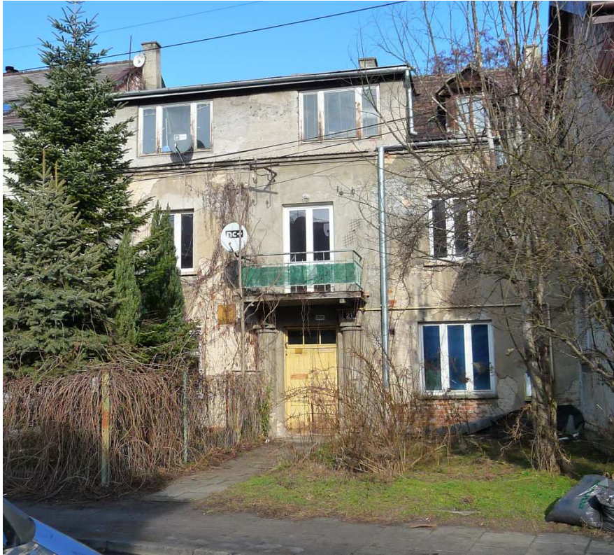
Fot. nr 240. Murowany dom pod nr 21 z mocno już zniekształconą fasadą. (26.01.2025)
