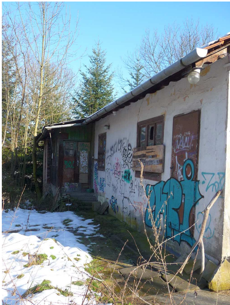
Fot. nr 220 (220-222). Dogorywająca chałupa w ogrodzie przy ulicy Malczewskiego 4. (19.01.2025)
