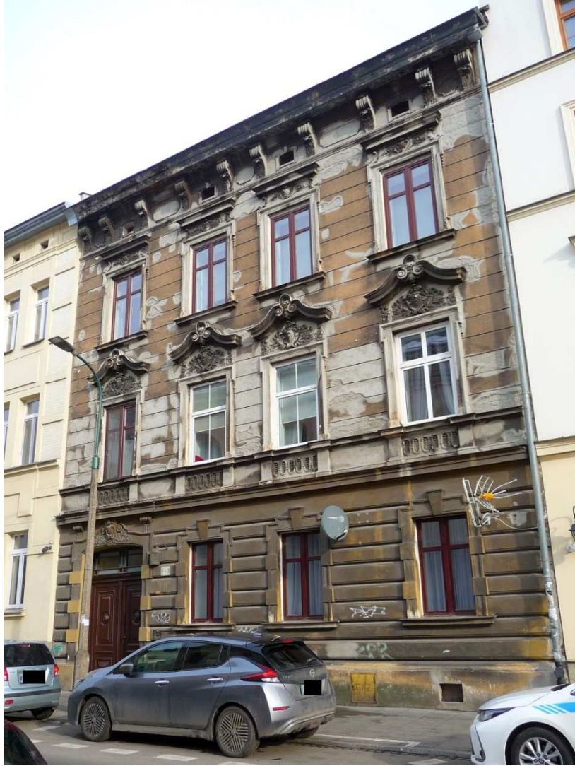
Fot. nr 291. Kamienica pod nr 25, której fasada nie budzi zachwytu. (21.01.2025)
