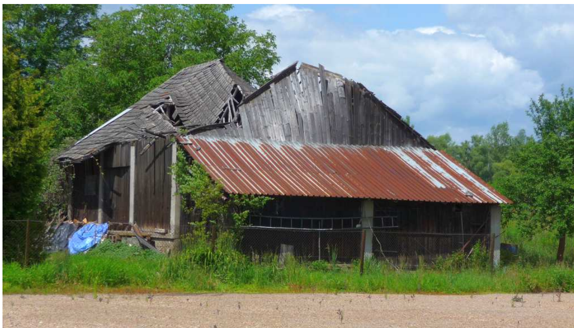
Fot. nr 15. Zawalony dach dużej stodoły. (24.06.2025)
