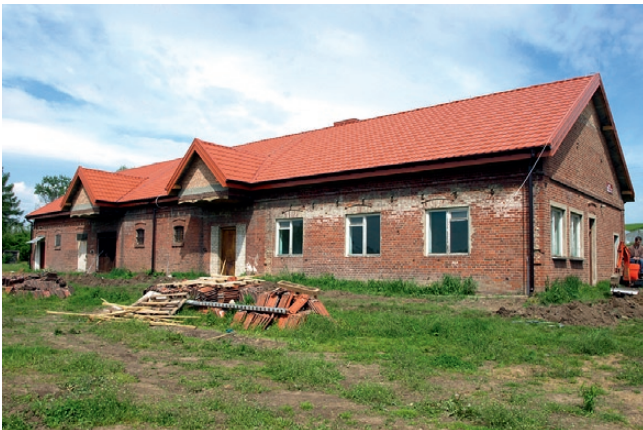
Dobiegają końca prace przy wymianie pokrycia dachowego na świetlicy wiejskiej w Książnicach Małych
