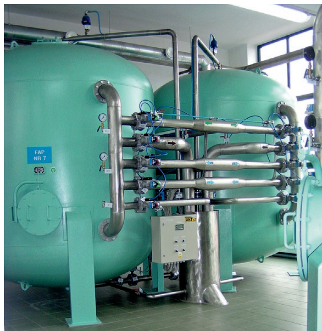
Stacja uzdatniania wody w Starym Korczynie
