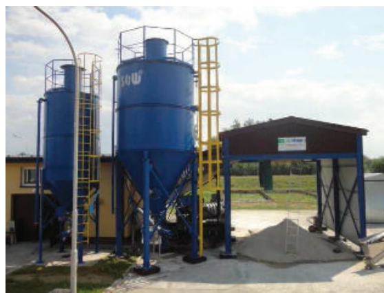
Linia technologiczna. Fot. O. Kabat
