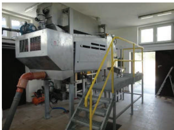
Linia technologiczna. Fot. O. Kabat
