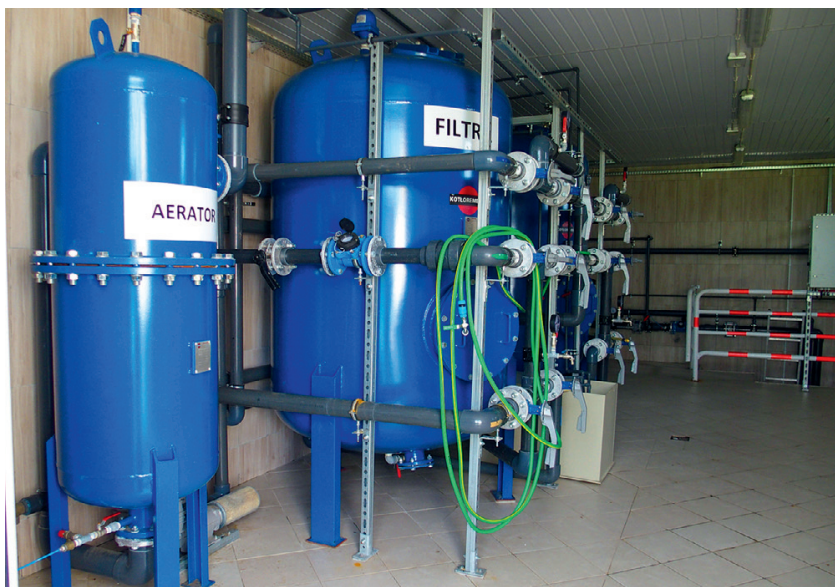
Urządzenia stacji uzdatniania wody w Witowie
