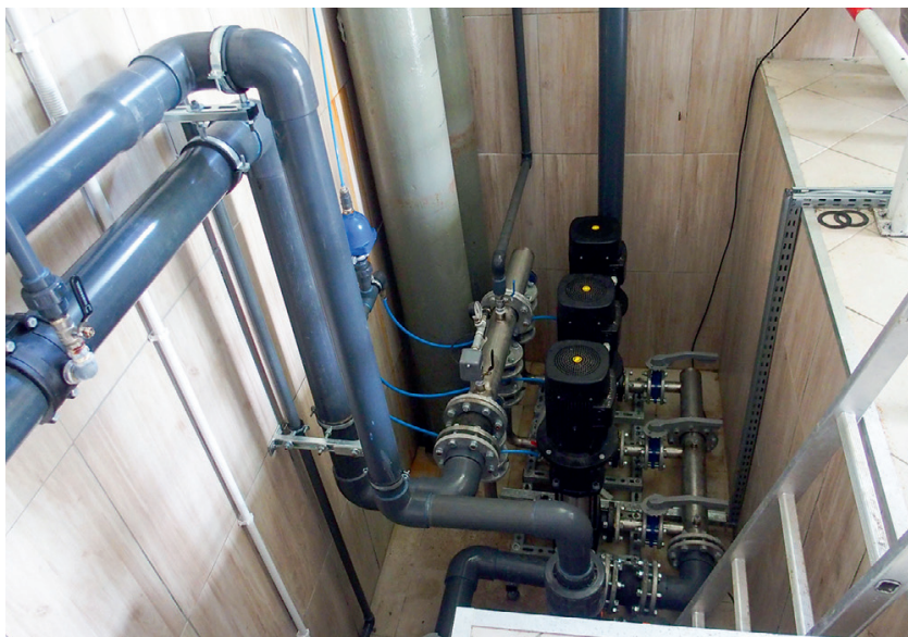
Pompy w stacji uzdatniania wody
