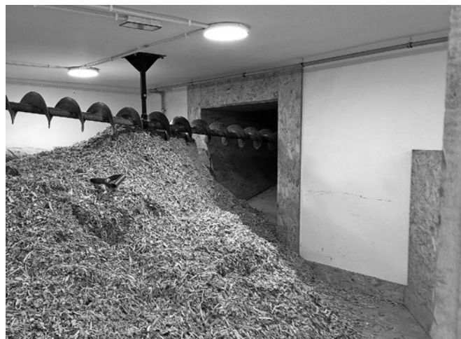
Magazyn zrębek w kotłowni w szkole w Książnicach Wielkich
