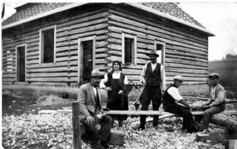
Budowa Domu Ludowego, 1932 (lub 1933)r. Od lewej: Franciszek Baran, sołtys i naczelnik straży pożarnej w Sieprawiu, prowadzący nadzór nad budową, kobieta NN, Jan Oramus, majster ciesielski, Joachim Oramus, Adam Oramus, syn Joachima.
