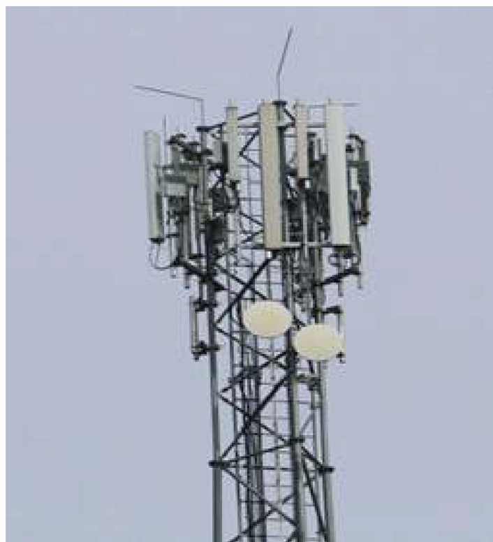
Stacja bazowa telefonii komórkowej po domontowaniu dodatkowych anten wiosną 2016 r.
