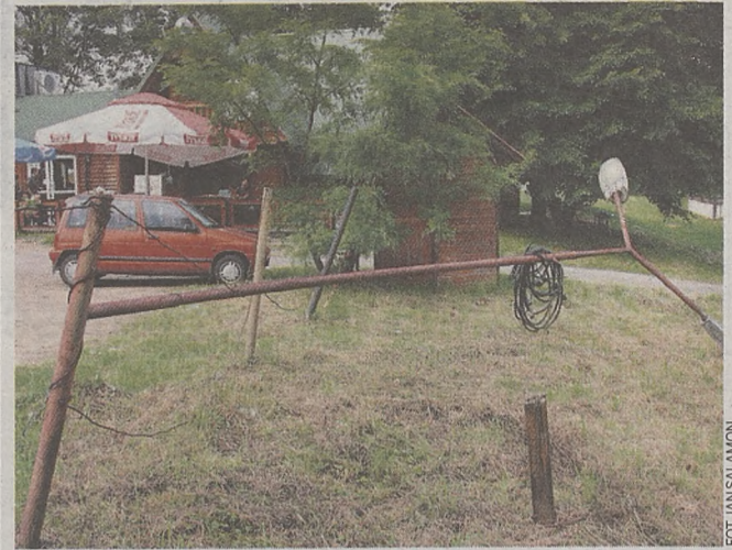
Zdewastowana lampa w centrum Czchowa
