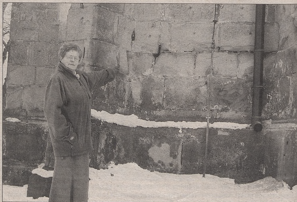
– Wiatr i deszcz nie oszczędziły murów. Są w opłakanym stanie – mówi Stefania Jochym z Łapczycy
