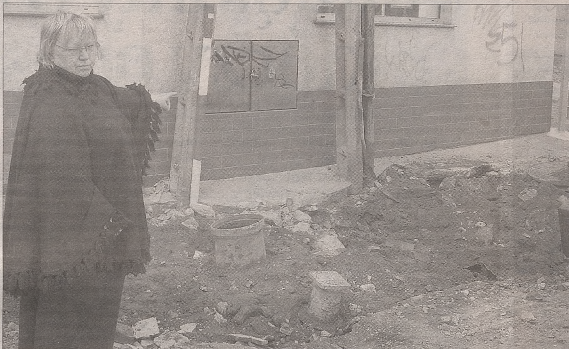
W tym miejscu powstały rysy – wyjaśnia Bożena Zaczyńska, właścicielka zakładu przy Rzeźnickiej
