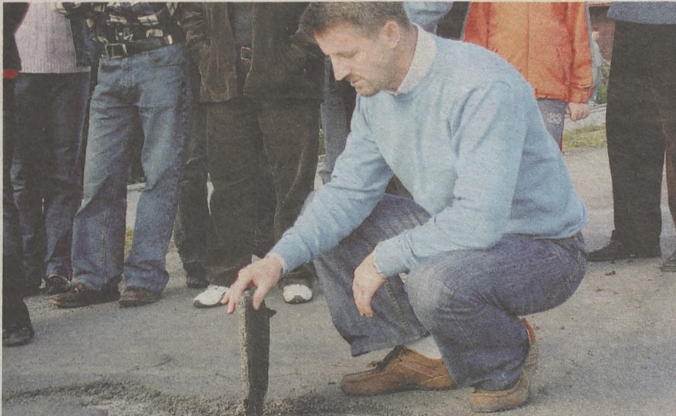
Jesienią ubiegłego roku asfalt na drodze w Woli Dębińskiej mieszkańcy mogli zrywać rękami
