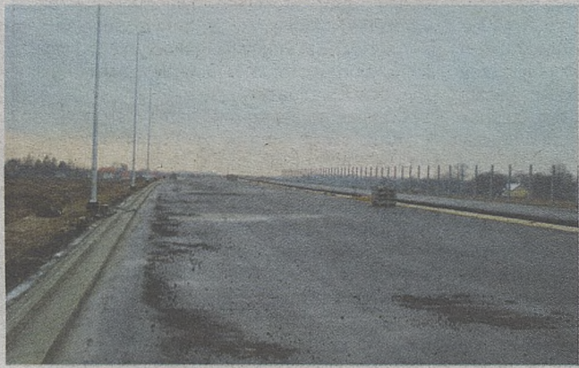
Autostrada do Brzeska jeszcze w budowie, ale we wrześniu ma być gotowa
