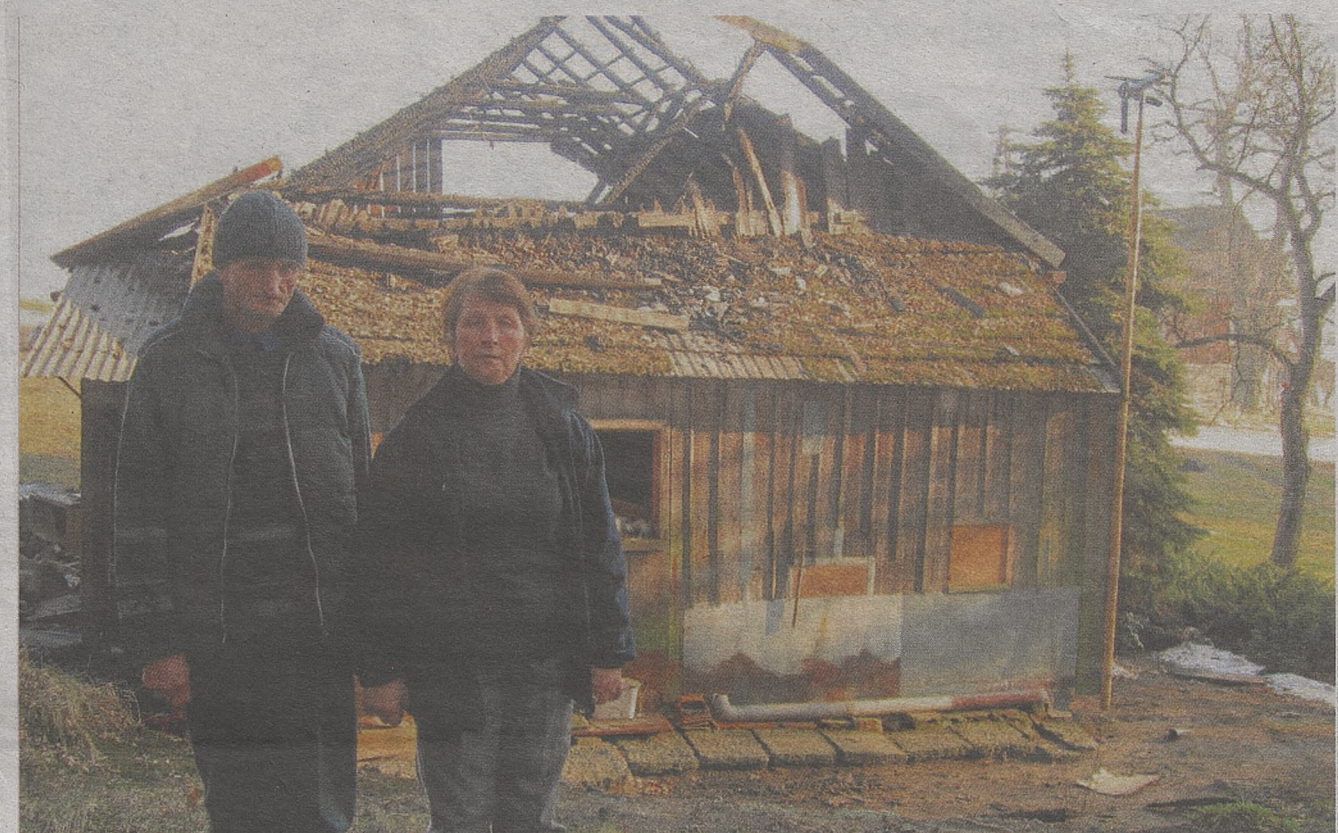
► Z domu w Połomiu Dużym, w którym mieszkali od urodzenia Danuta Kmiecik i jej starszy brat Kazimierz, po pożarze zostało niewiele
