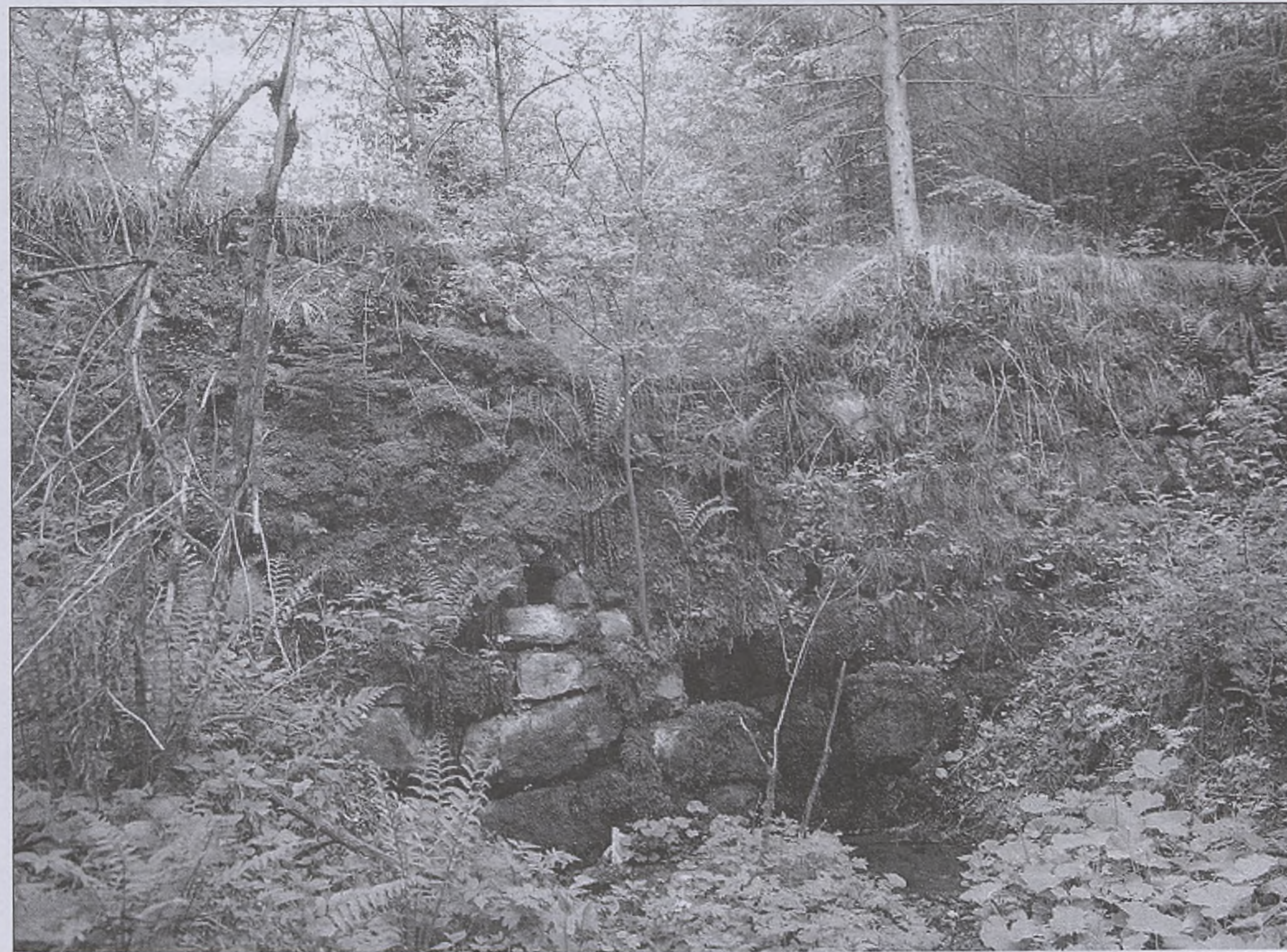
Stan techniczny tam na potoku Gorzki w 2022 r. Fot. J. Ceklarczyk
