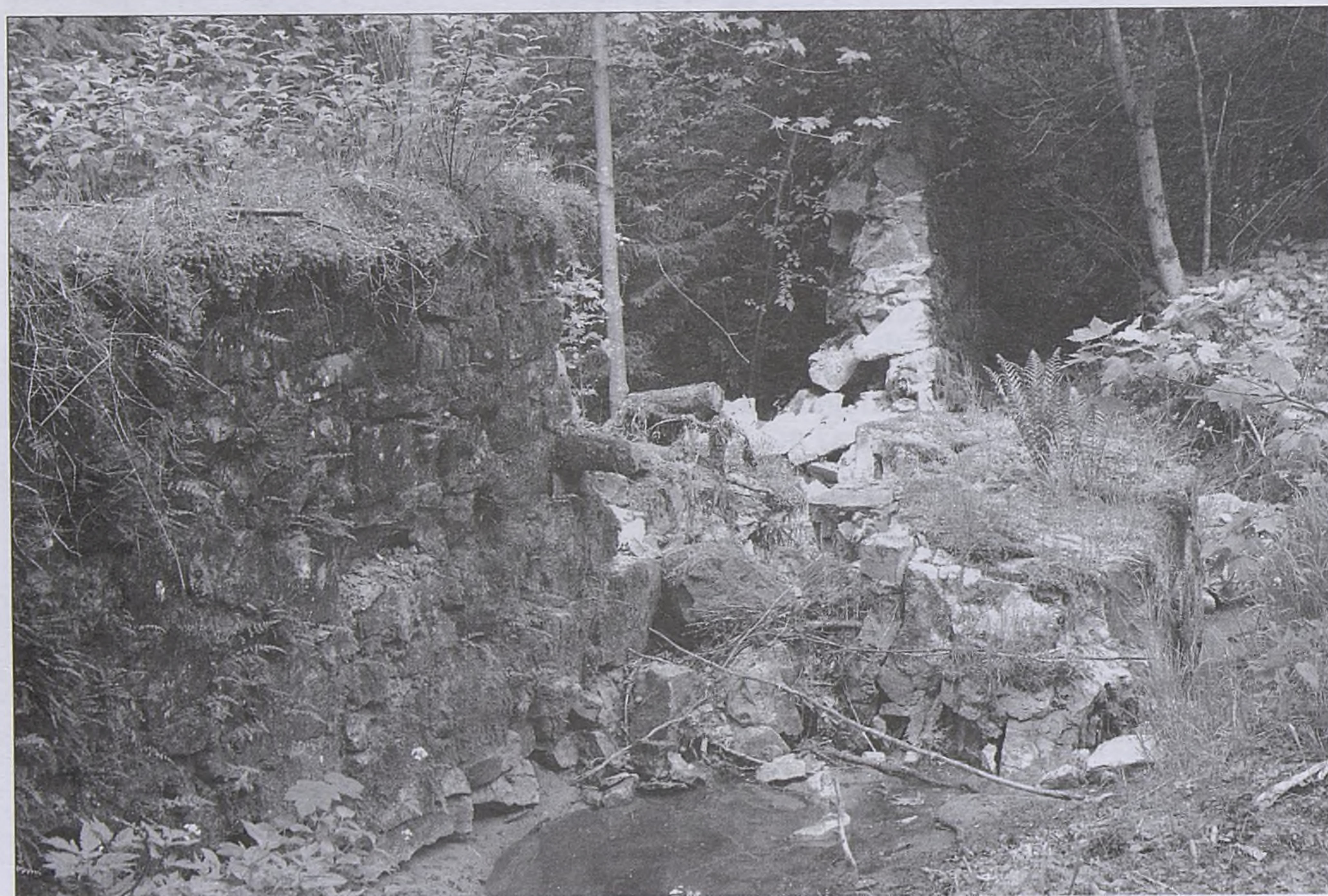
Uszkodzenia jednej z zapór na cieku głównym, 2022 r. Fot. J. Ceklarz
