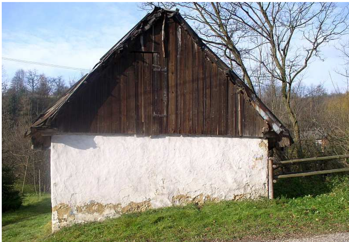
Fot. nr 54. Boczna część obiektu. W prawym narożu dachu, spod pokrycia wygląda jeszcze słoła. (11.11.2010)
