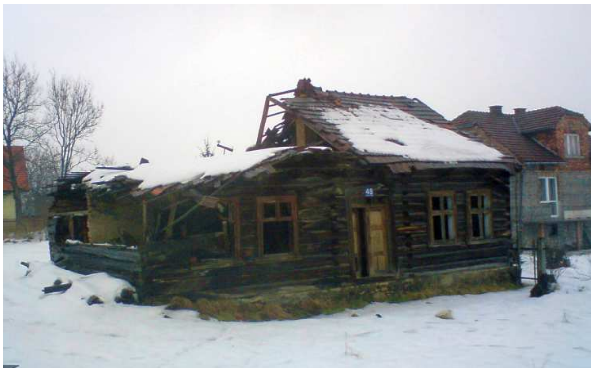
Fot. nr 67. Widok części spalonej. (11.03.2010)
