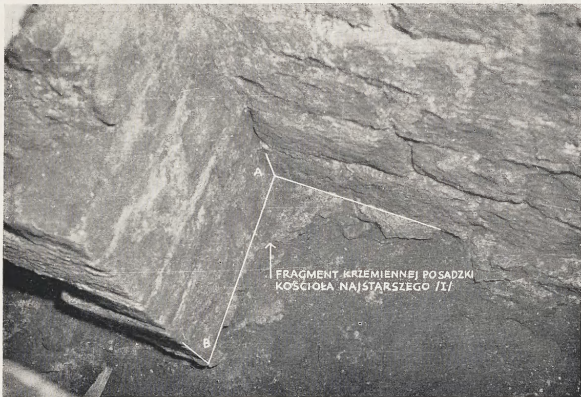
Fig. 16. Kościół Św. Salvatora. Prezbiterium. Widok odsłoniętego w czasie badań w r. 1961 węgła najstarszej budowli
