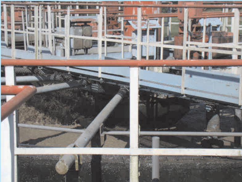
Zużyta oczyszczalnia ścieków wymaga gruntownej modernizacji
