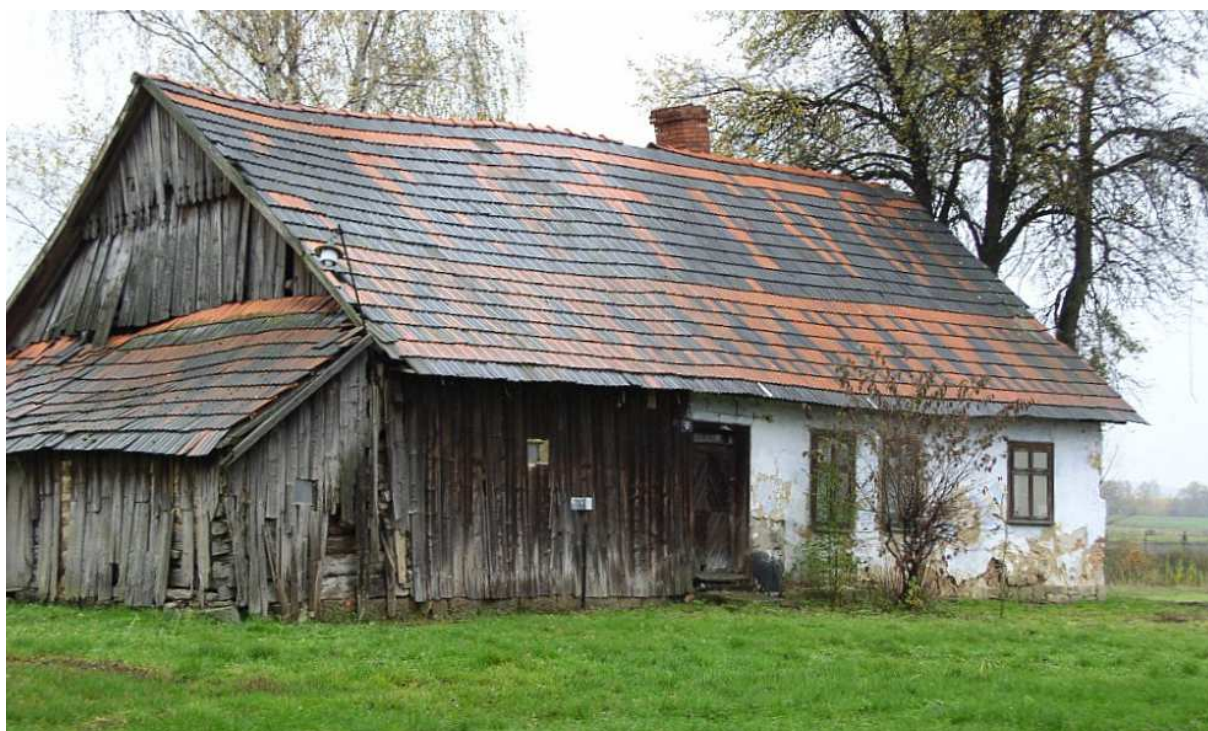
Fot. nr 275 (275-278). Widoki na fasadę nieistniejącego już domu Władysława Grabowskiego, pod nr 17, w którym dożył on niemal setki, uchwycone niedługo po jego śmierci w 2006 roku. Dom ten prawdopodobnie wybudował jego ojciec Józef w roku 1907, a może 1901, jak twierdzi Mikołaj Kornecki, wkrótce po ślubie z Franciszką Godulą, jego drugą żoną. Tu stan z (01.11.2008).
