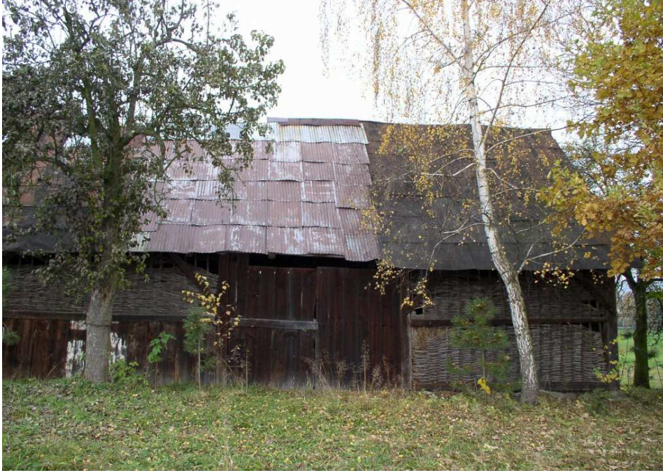
Fot. nr 124. Stodoła Urbanów, dawniej Godulów, jeszcze do niedawna kryta strzechą oryginalny tył z połowy XIX-go wieku, jeszcze z wiklinowymi ścianami.
