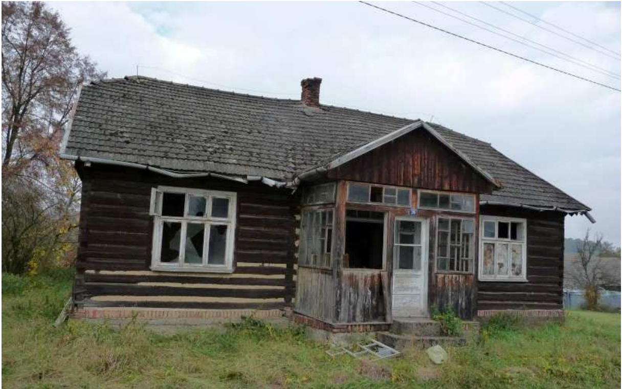
Fot. nr 56. Opuszczony dom Stanisława Ścibora – stan obecny (31.10.2011).
