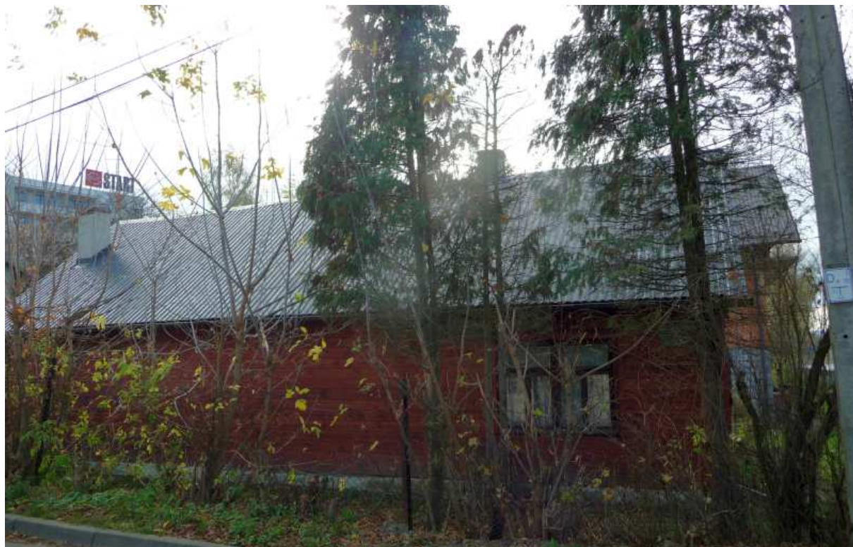
Fot. nr 33. Oryginalne okna podmiejskiego kiedyś domku z ulicy Malwowej 5 (28.10.13)
