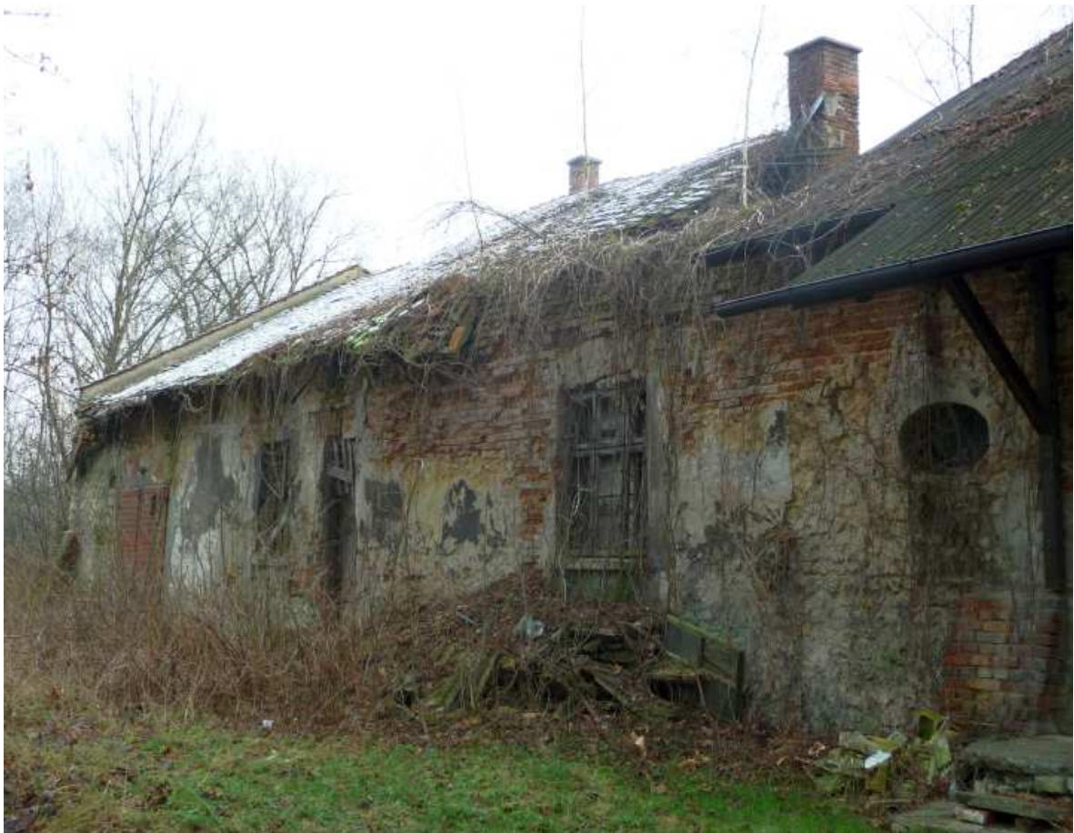
Fot. nr 10. Ruina zabudowań gospodarczych przylegających do dworu. (21.12.12)
