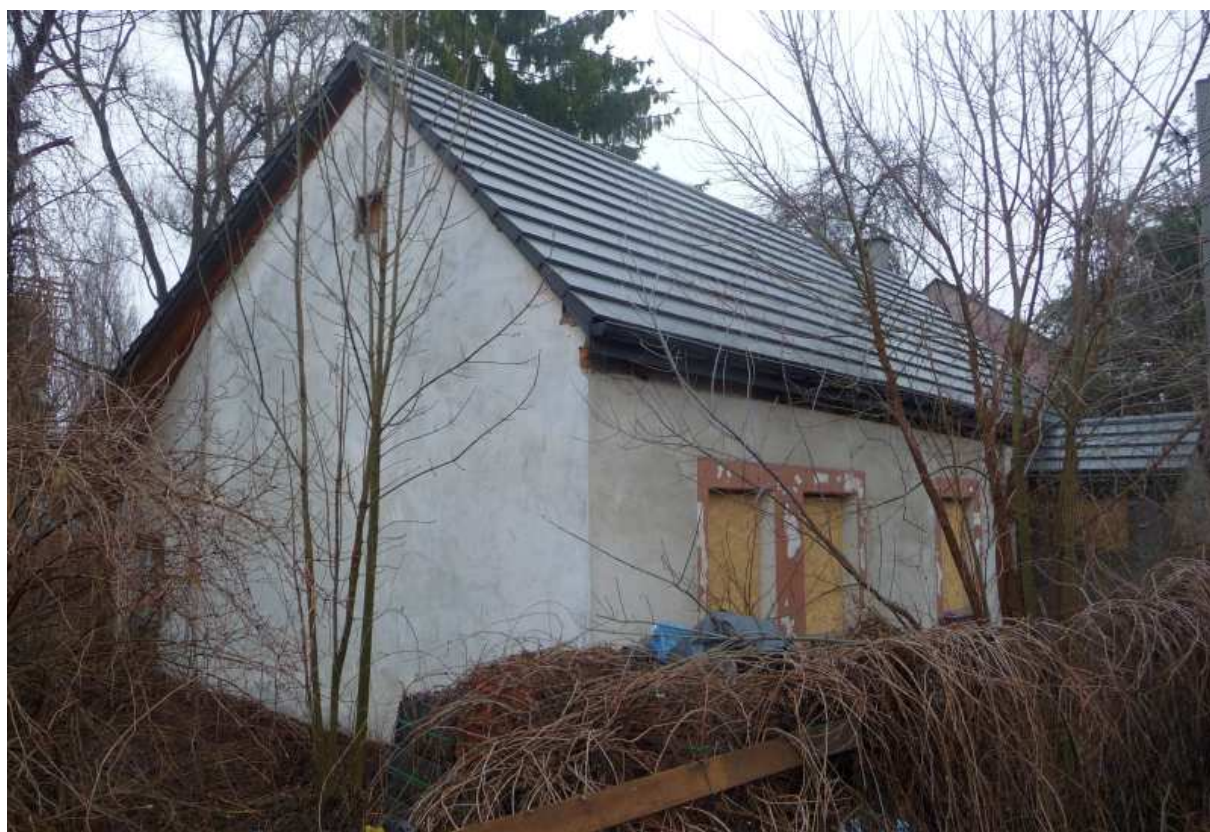
Fot. nr 40. Agonia murowanego domku z ulicy Malborskiej 36. (19.01.14)
