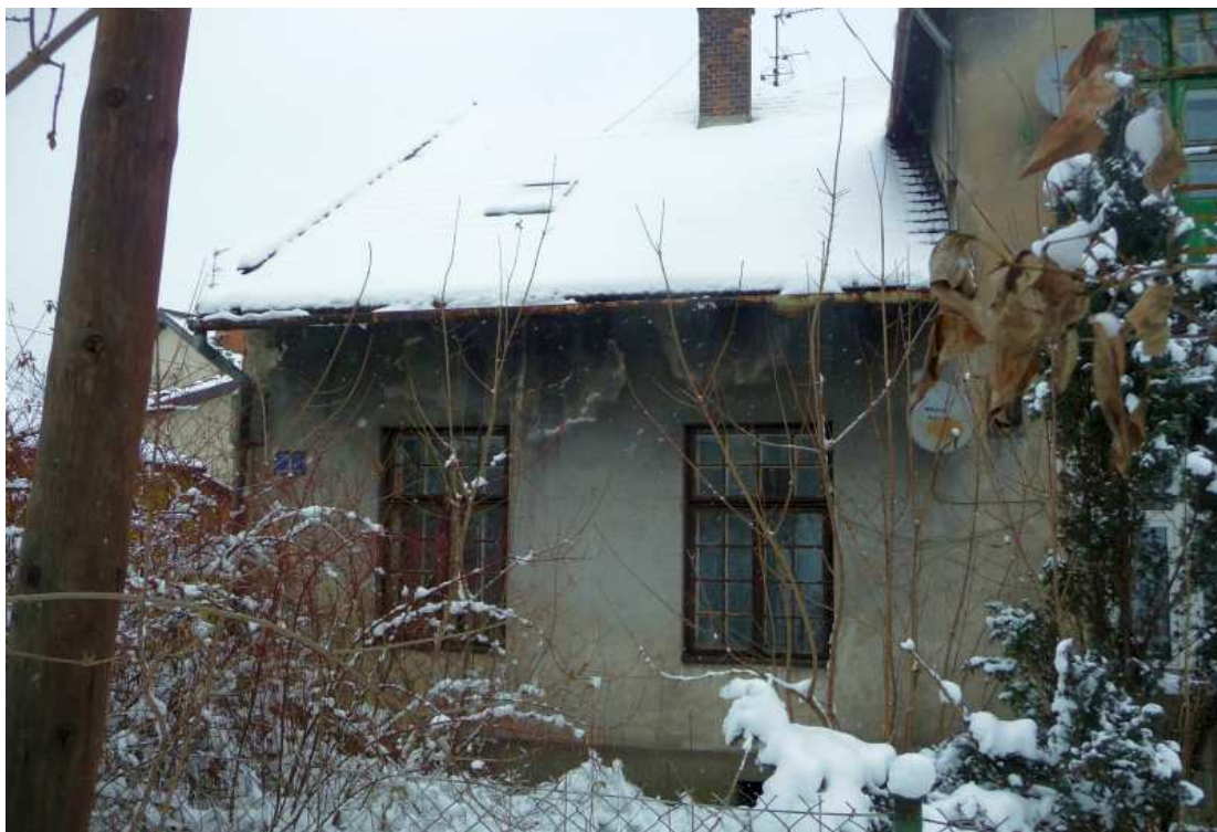
Fot. nr 51. Oryginalne okna. (28.01.14)
