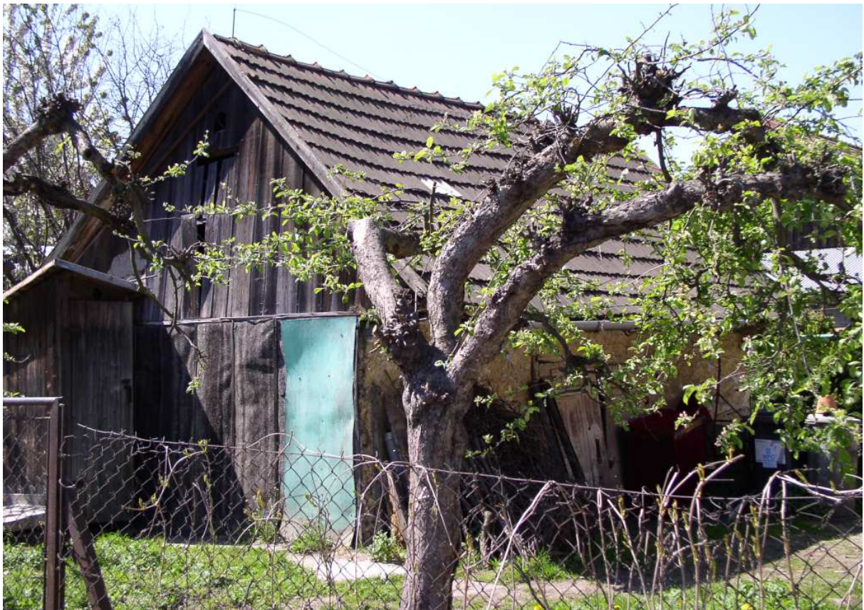
Fot. nr 344. Budynek gospodarczy (stodoła?) i przylegająca do niego wygodka na podwórku domu spod nr 204. (25.04.2009)
