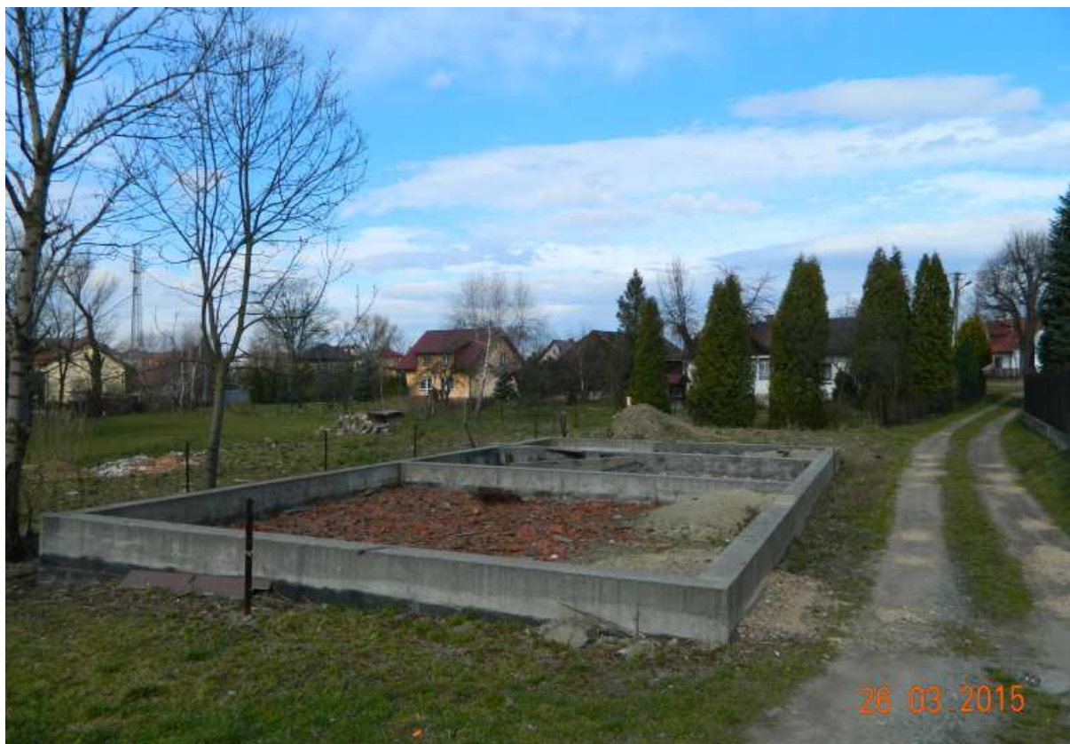
Fot. nr 142 (142-143). A tu już pusta przestrzeń i fundamenty po wyburzonym w roku 2009 obiekcie.
