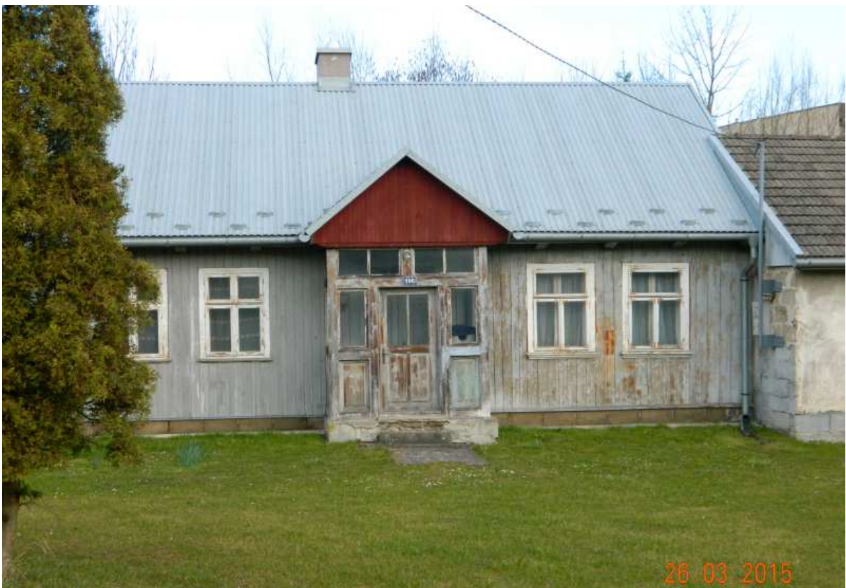
Fot. nr 392. Dwa typy okien w fasadzie: trójkwaterowe (z prawej) i chyba nieco starsze, czterokwaterowe (z lewej).
