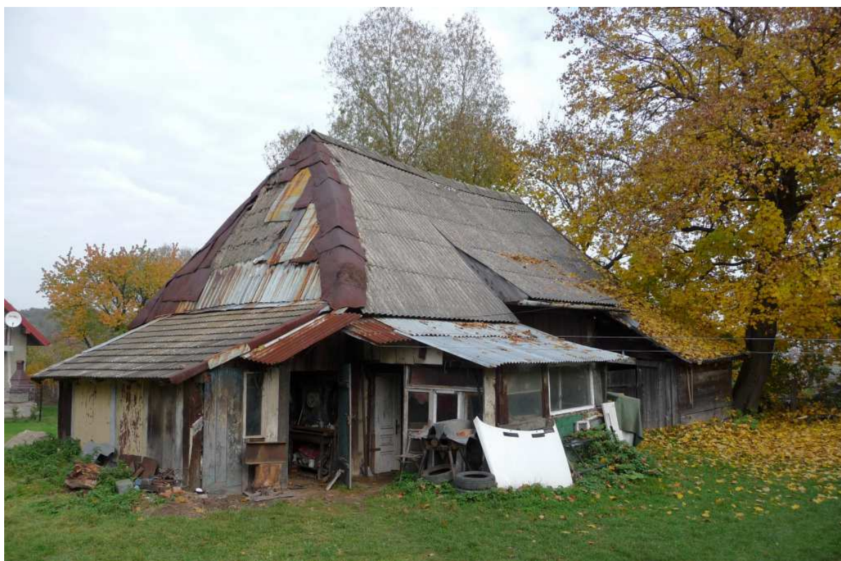
Fot. nr 137. Spod eternitu miejscami wystaje jeszcze strzecha. (31.10.2011)
