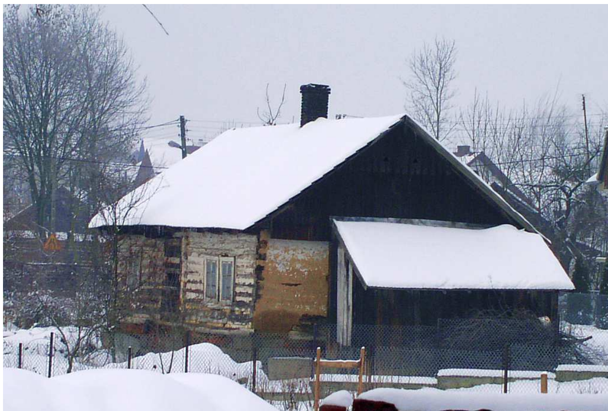
Fot. nr 56. Widok spod dworu. Zachowały się stare belki w układzie zrębowym, a nawet okna. Jej los wydaje się być przesądzony. (18.01.2010)
