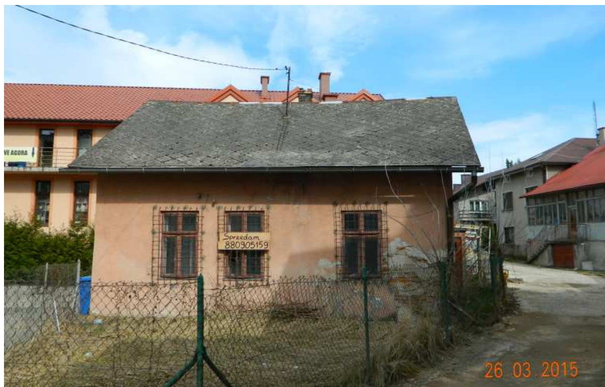
Fot. nr 151. Ostatnie tchnienia domu spod nr 205 przy ulicy Solskiego.
