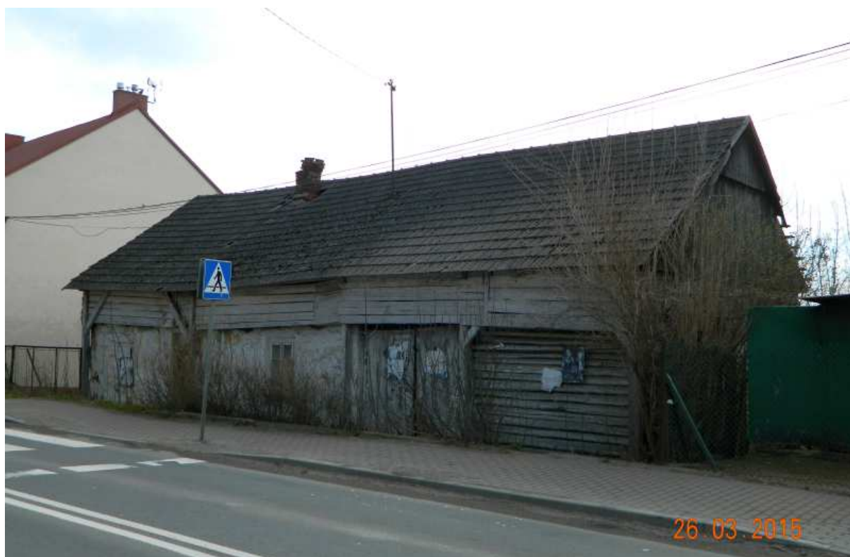
Fot. nr 43 (43-46). Kolejny oryginał z ulicy Bocheńskiej spod nr 148, którego stan jest dramatyczny i źle wróży.
