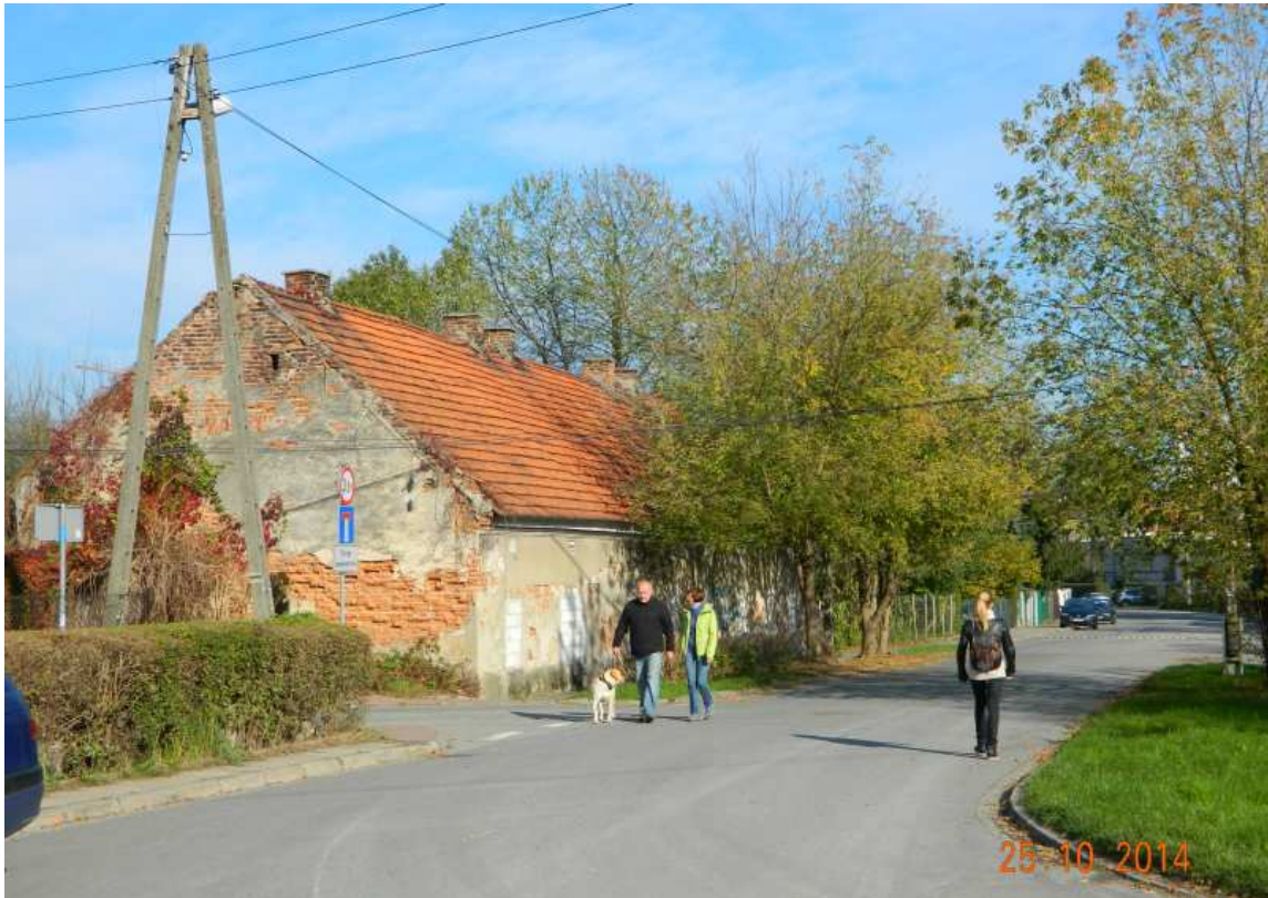
Fot. nr 26. Końcowy fragment ulicy Twardowskiego z ruiną domu pod nr 117.
