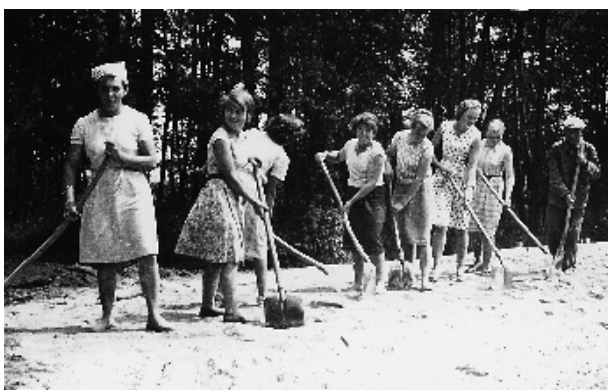
Inna grupa przy pracy. Rozsypywanie cementu na nawieziony wcześniej żwir i piasek.
