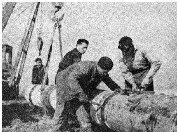
Prace przy zakładaniu gazociągu. Do końca 1970 roku gaz otrzyma dalszych 10 wsi brzeskich.
