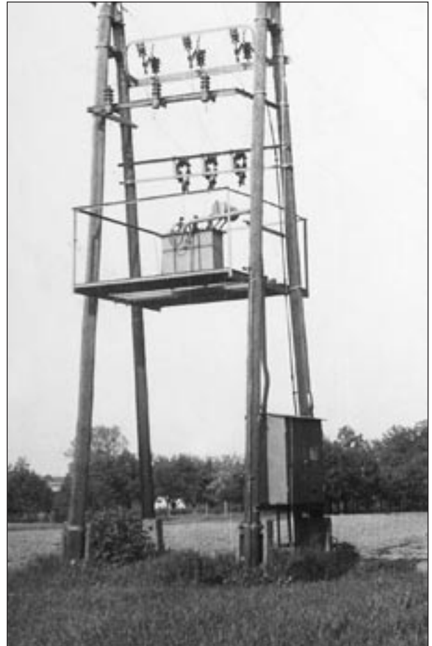
Pierwszy transformator w ramach planu elektryfikacji powiatu zbudowany w Szczepanowie.
