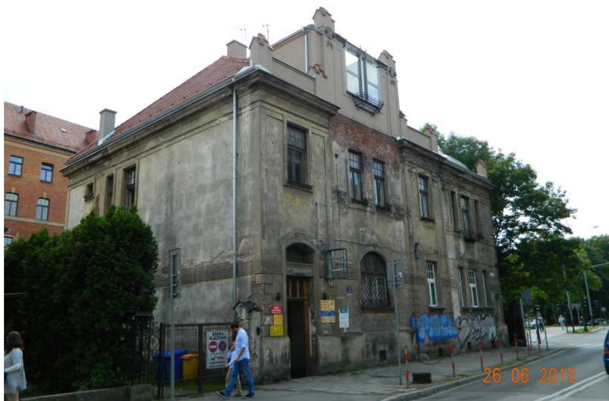
Fot. nr 61. Zanedbywana od dekad, secesyjna willa z ulicy Czarnowiejskiej 8.
