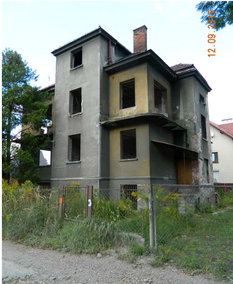
Fot. nr 120. Ruina przedwojennej willi (nr 39) przy wylocie ulicy Korzeniowskiego do Królowej Jadwigi. Przed II wojną światową w tym miejscu stała roгатka miejska.
