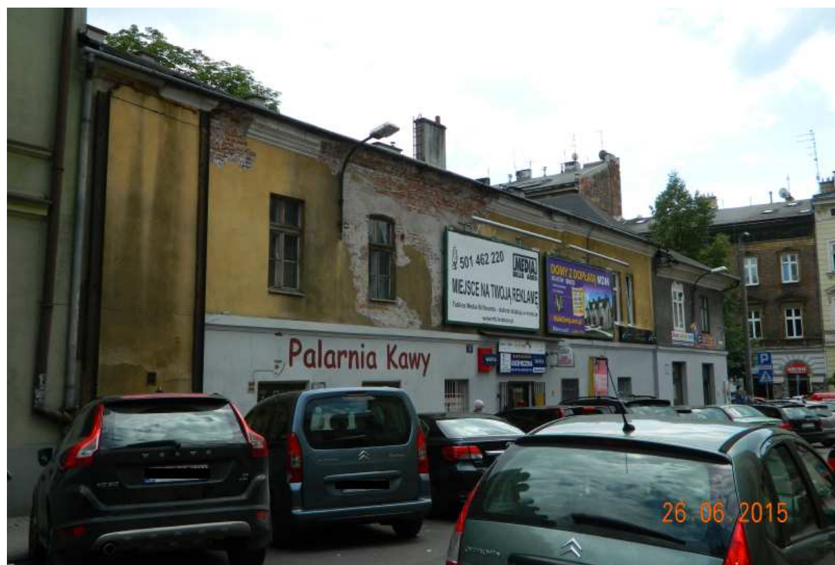
Fot. nr 35. Baner reklamowy na zaniedbanej ścianie kamieniczki z ulicy Garbarskiej 26.
