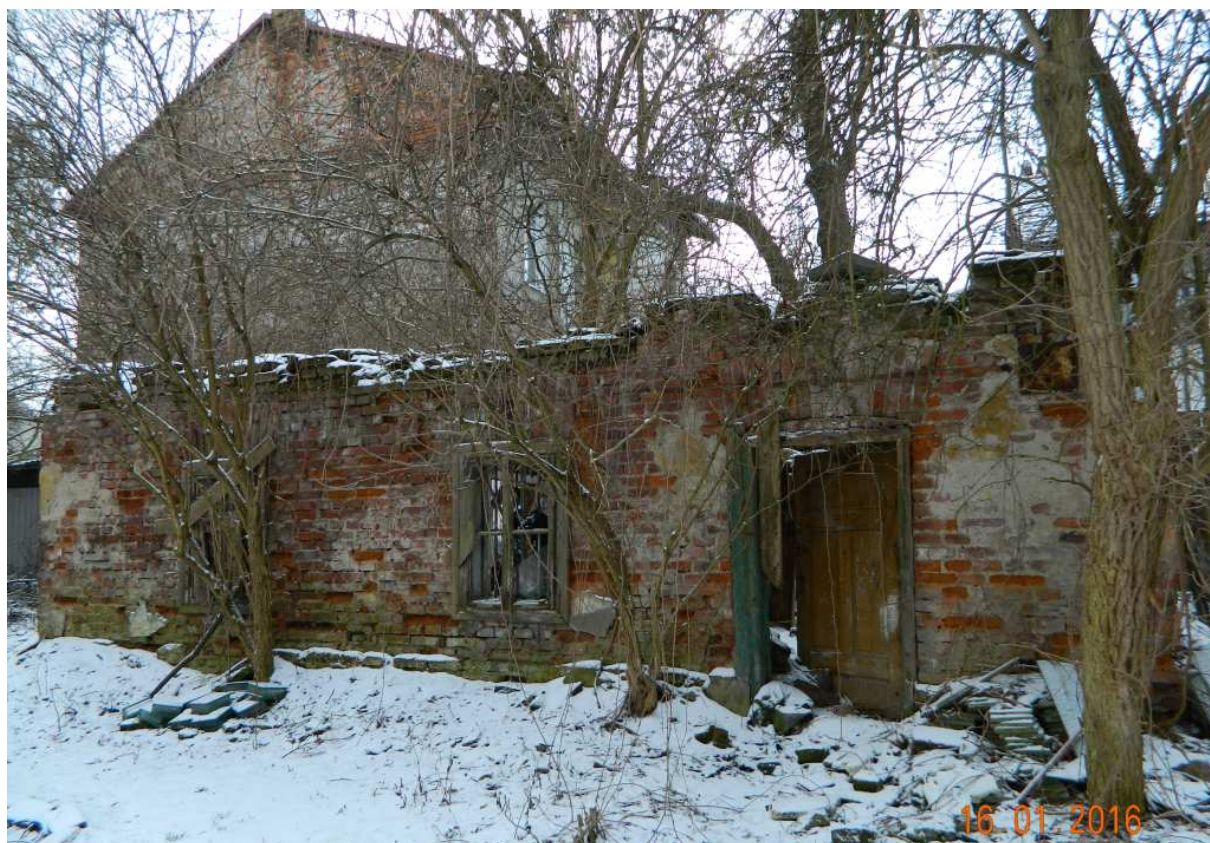
Fot. nr 69 (69-71). Ruina pomieszczenia gospodarczego przylegającego do willi.
