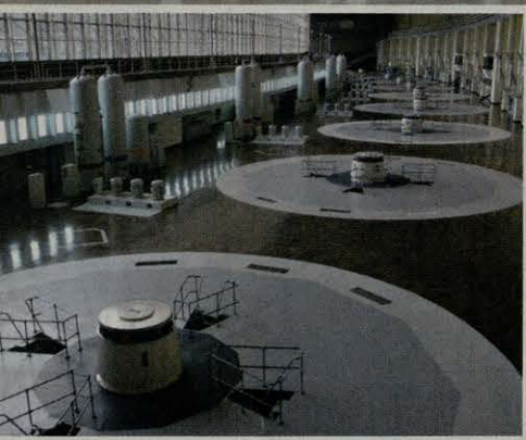
Po wybuchu pierwszej turbiny pękł dach i woda zalała całą maszynownię. Poniżej: Stan sprzed tragedii
