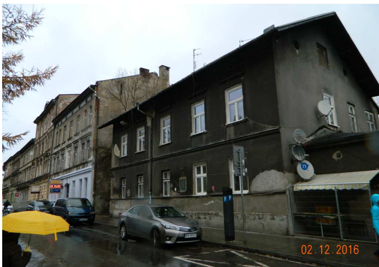
Fot. nr 23. Zaniedbana zabudowa ulicy Strzeleckiej z przełomu XIX i XX wieku.
