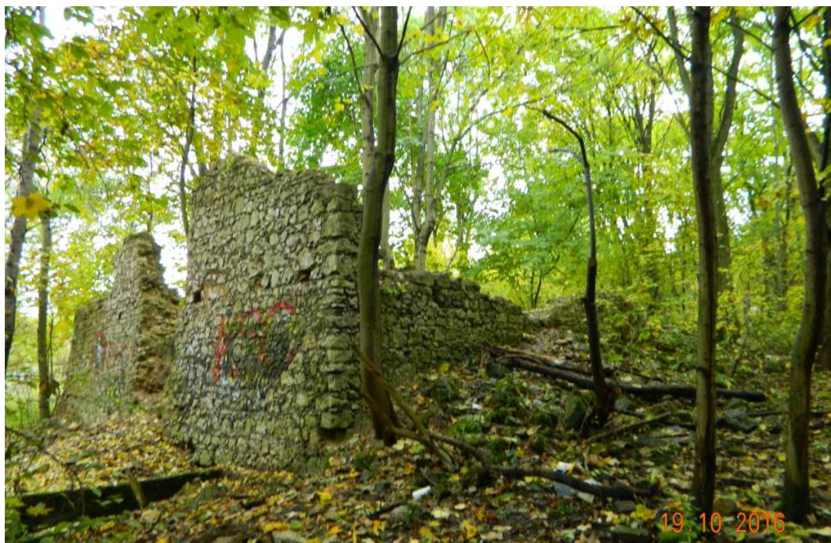
Fot. nr 222. Ruina budynku gospodarczego we fragmencie od strony ulicy Albańskiej.
