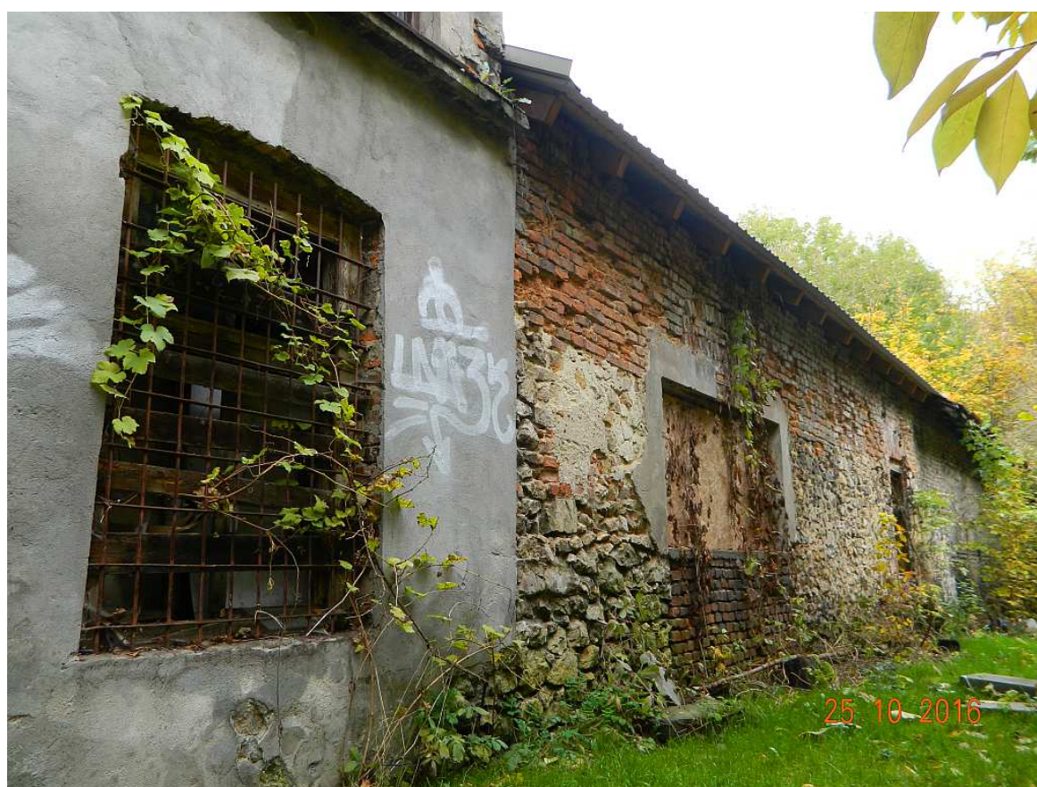
Fot. nr 207. Ruina budynku gospodarczego przylegającego do dworu.
