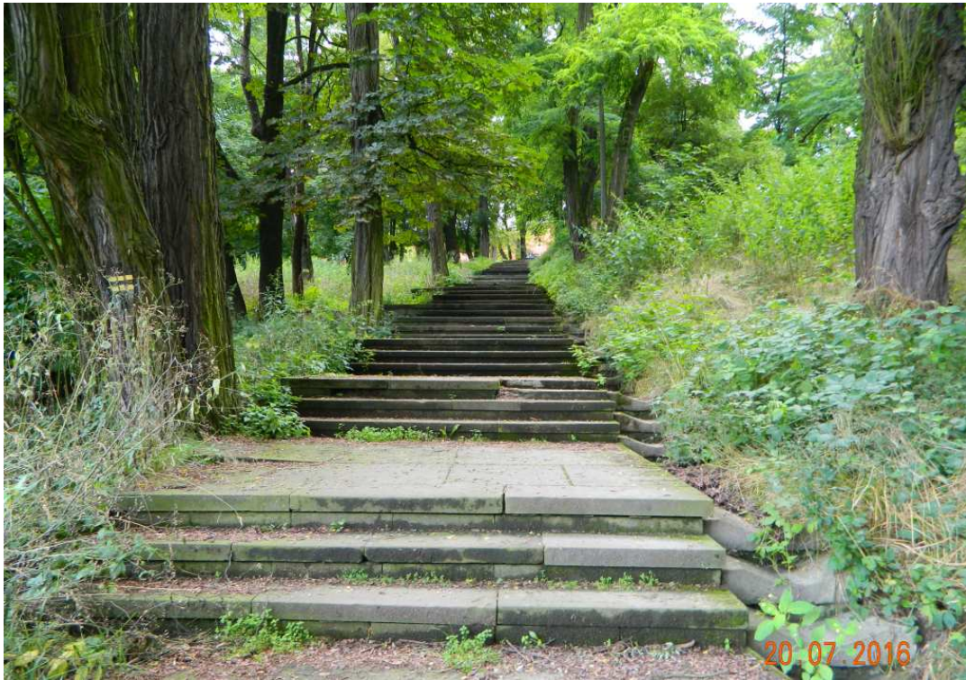
Fot. nr 12. Schody wiodące z Alei Waszyngtona pod bastion nr V fortu Kościuszko, które zostały wykonane pół wieku temu, ale dziś jakby o nich zapomniano.
