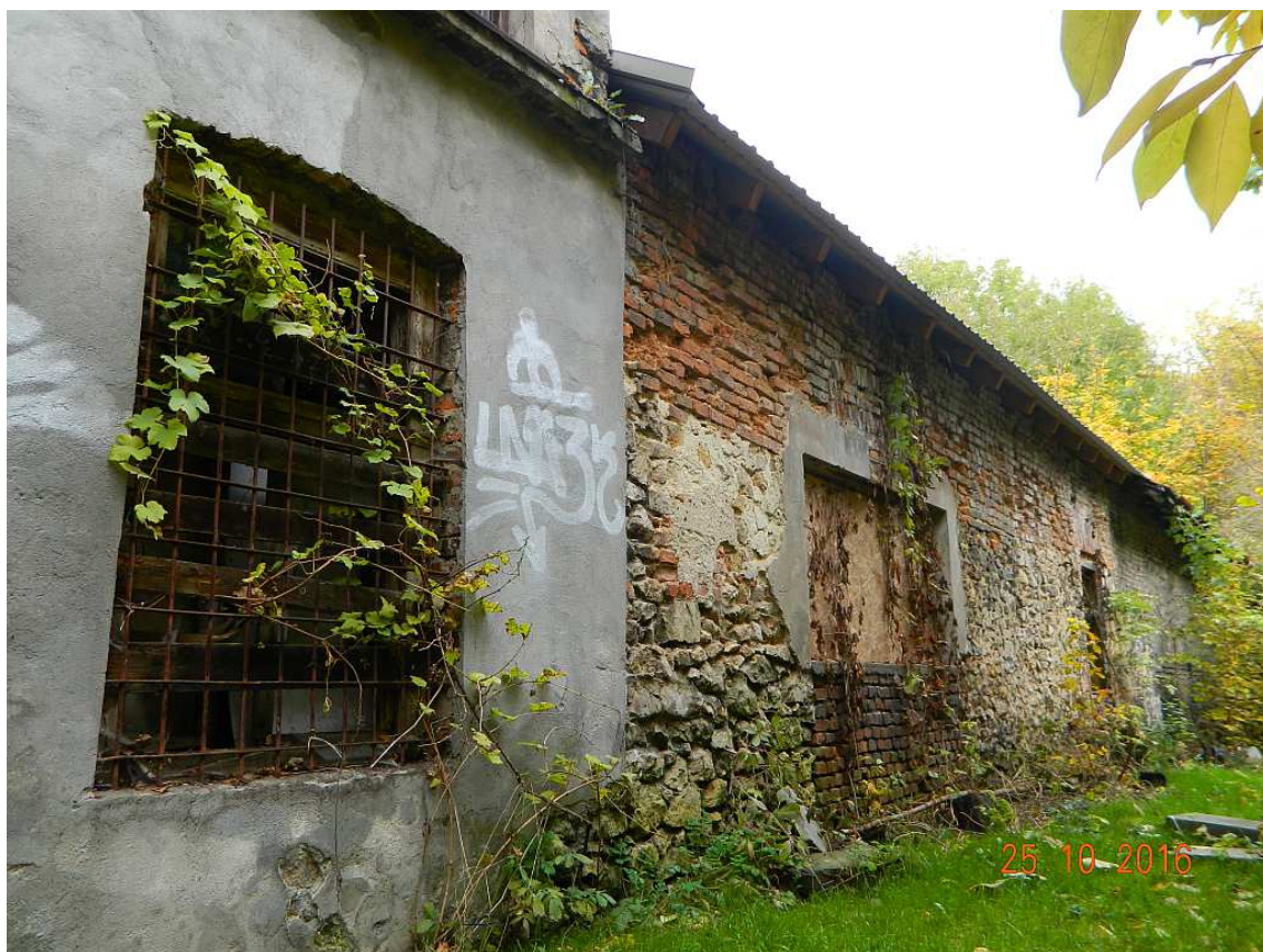
Fot. nr 84 (84-85). Ruina budynku gospodarczego, prawdopodobnie dawnej wozowni, przylegającego do dworu z prawej strony.
