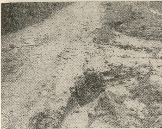
Ryc. 3. Niszczenie poboczy drogi gruntowej. Efekty po opadzie burzowym. Fot. autor
