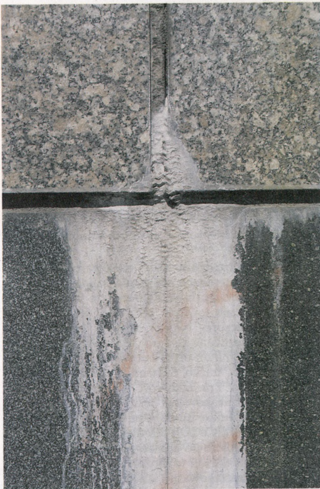
Ryc. 4. Solne wycieki szpecące granitowe płyty okładzinowe – to efekt niewłaściwej metody ich umocowania
