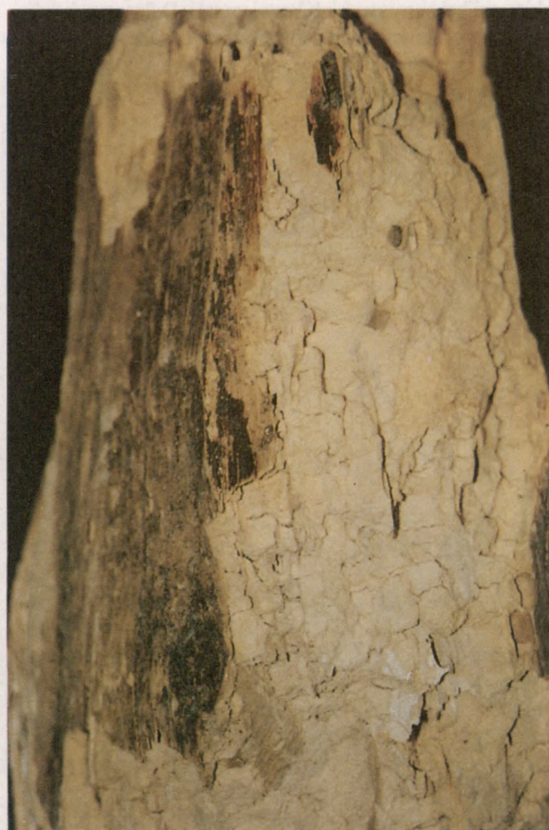
Ryc. 2. Fragment konstrukcji dachowej uszkodzonej przez żer larw spuszczela pospolitego. Fot. autor
