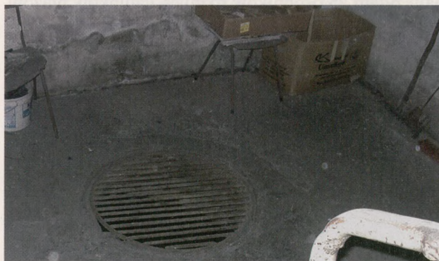
Ryc. 2. Studzienka w podłodze kotłowni. Sorkwity 17 stycznia 2009. Fot. Maria Olszowska
